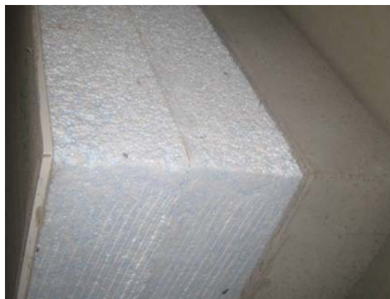
Abb. 21: Wärmedämm-Verbundsystem mit 200 mm Dämmstoffdicke auf einer Stahlbetonplatte (Seitenansicht). Die Dämmschicht bestand aus zwei aufeinander
