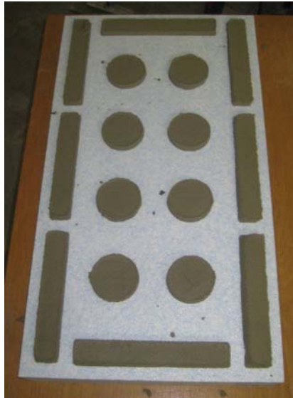
Abb. 14: Dämmstoffplatte aus Polystyrol vor der Befestigung auf der Grundwand. Der Klebemörtel wurde mit der in Abb. 13 dargestellten Schablone aufgetragen.
